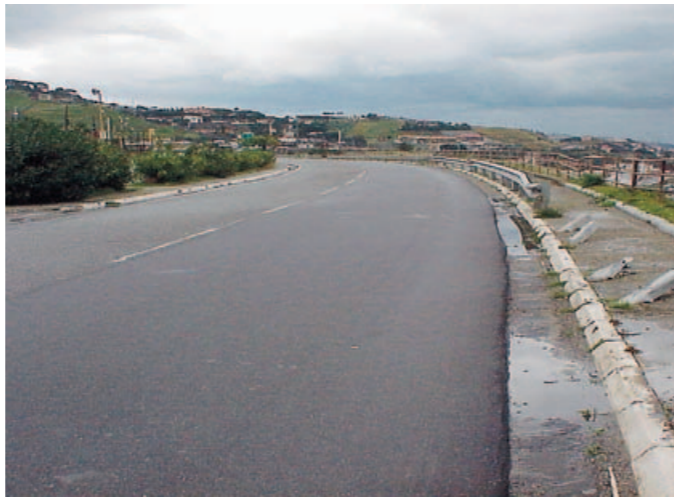
La "Nuova Panoramica dello Stretto" dove è stato causato il danno
